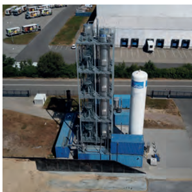
Der Energiepark in Pirmasens-Winzeln
